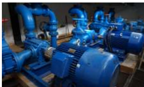
Pompes électriques de l'ASA du Canal du Caïre © P.CHEVALIER
