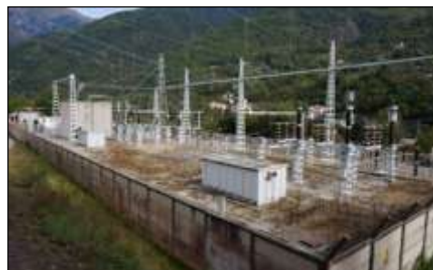
Poste de transformation RTE © J.JEANNE
